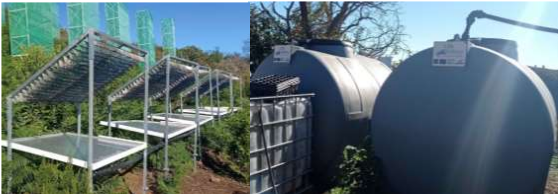
Fig.31: Sistema de captação e de adução da água captada para reservatórios em Gran Canária, financiado pelo projeto TREEMAC – imagens registadas durante a visita a Gran Canária em finais de novembro de 2022, no quadro da reunião de parceiros do TREEMAC.
